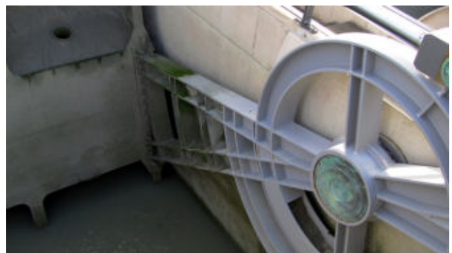
Schleusentor mit wuchtigem Antriebsrad
