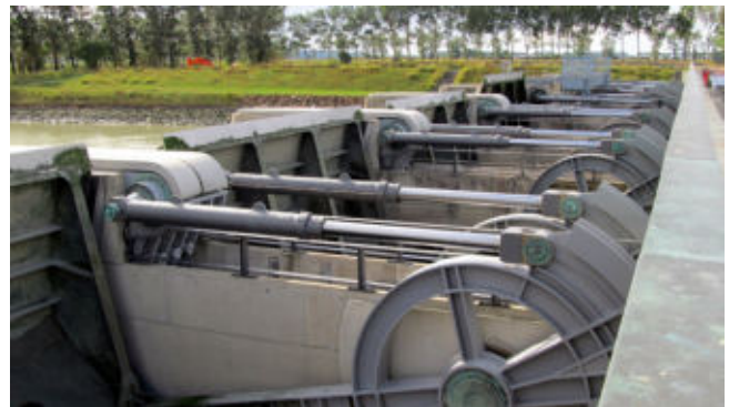
8 hydraulisch betätigte Schleusentore
